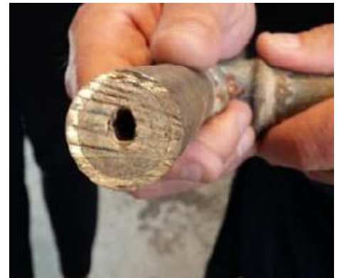
Eksempel på tilkalket vandrør
