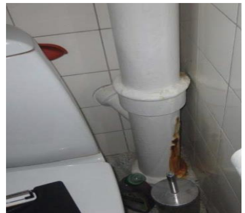
Eksempel på rust på faldstammer
